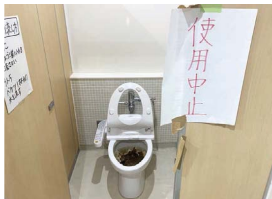
詰まりにより使用禁止になった避難所のトイレ
