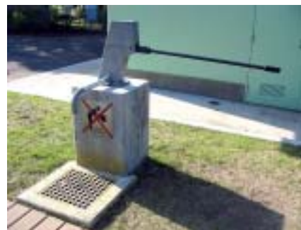
停電、断水時はハンドポンプにより井戸水を汲み上げ、水洗トイレとして利用できる。
