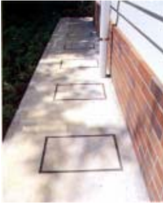
外周部に設置した 防災用ピット
