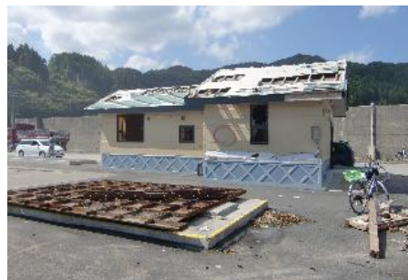
大槌町赤浜地先の公衆トイレ（手前浄化槽）
